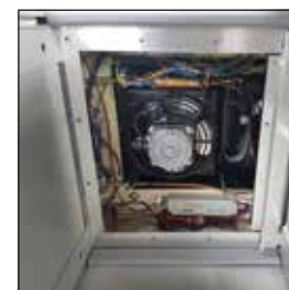
A5. Vano condensatore
