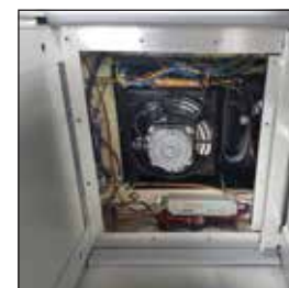
A5. Vano condensatore
