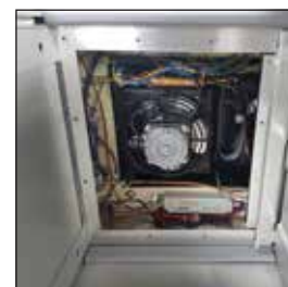
A5. Vano condensatore
