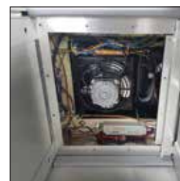
A5. Compartimento del condensador
