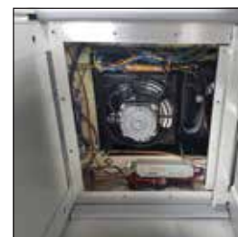
A5. Vano condensatore
